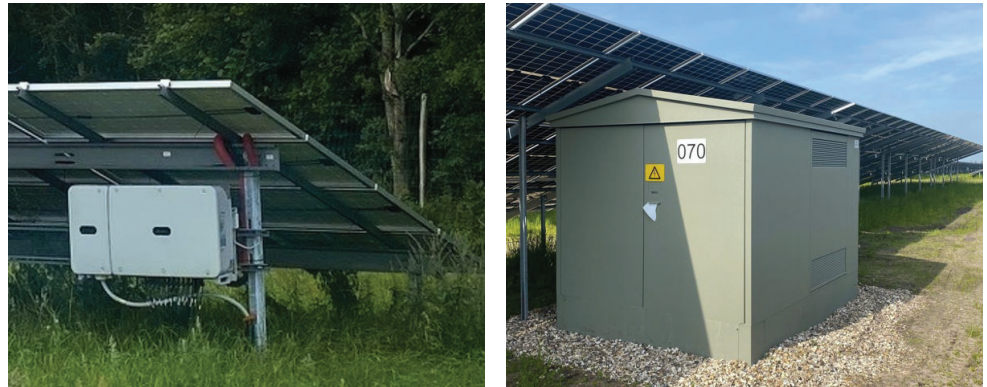
Figur 1-5 Eksempel på inverter (t.v.) og fordelingstransformer (t.h.).
