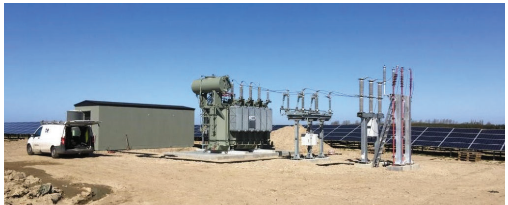
Figur 1-6 Eksempel på stepup-transformer og teknikbygning.
