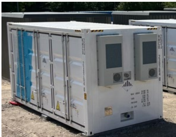
Figur 1-7 Eksempel på energiopbevaring med batteri i containerløsning.
