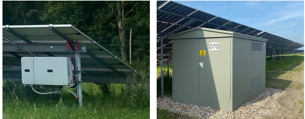
Figur 1-5 Eksempel på inverter (t.v.) og fordelingstransformer (t.h.).
