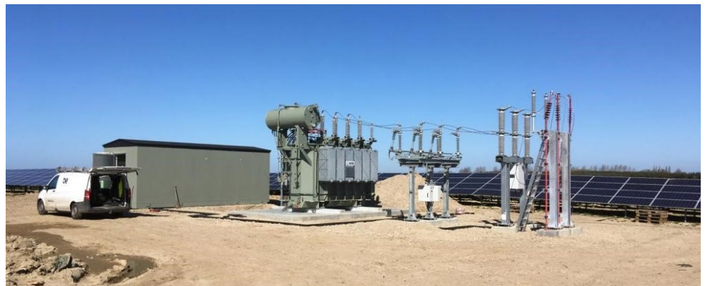
Figur 1-6 Eksempel på stepup-transformer og teknikbygning.
