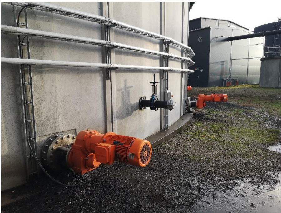
04 Jongia røreværk silobund
