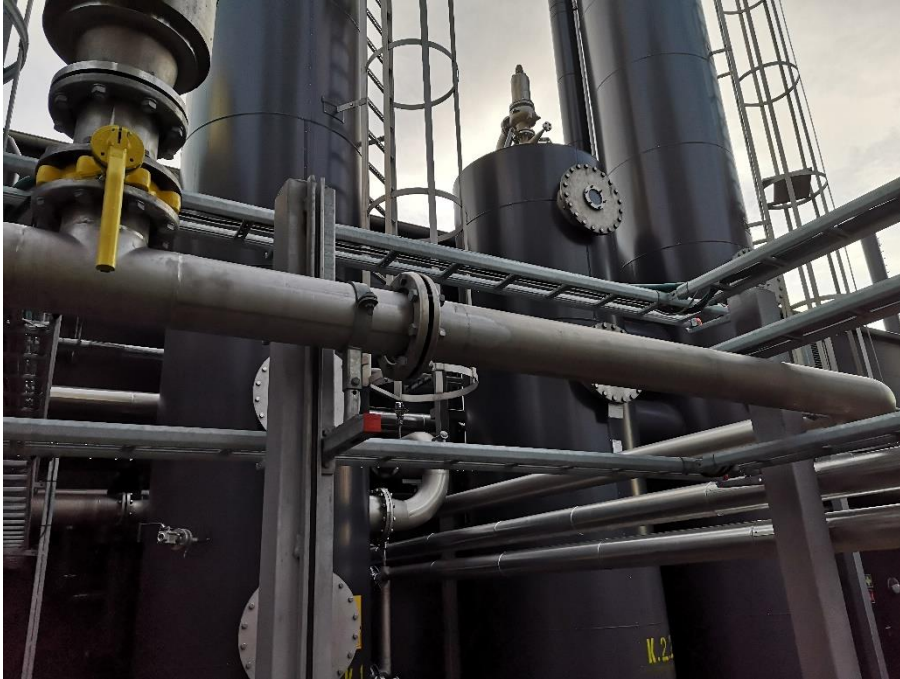
10 Rør mellem AMG og TS
